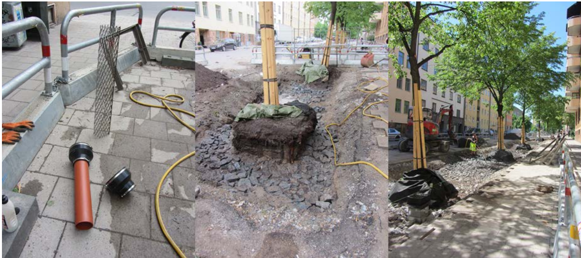
Figur 2. Bilder från restaureringen av växtbäddarna på Blekingegatan i Stockholm. På bilden till vänster syns de inväxtzoner i sträckmetall som användes för provtagning av rötter. De två bilderna till höger visar uppbyggandet av växtbädden, skelettjord enligt Stockholmsmodellen. Installationerna och växtbädden byggdes juni 2014.
